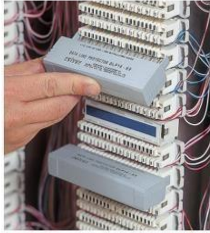
Şekil 112. Telefon devrelerinin fişe takılan aşırı gerilim koruma üniteleri ile korunması.
