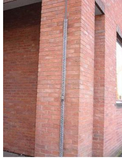
Şekil 53. Hasar ve vandallığa karşı dış koruma sağlanmalıdır
